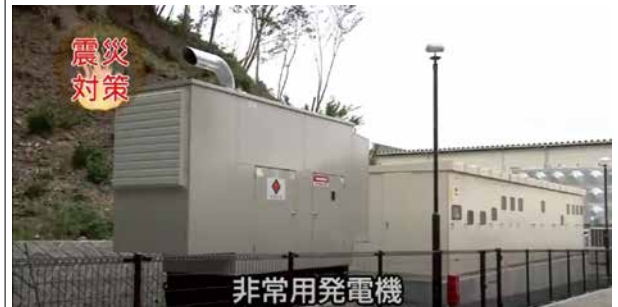
画12 非常用発電機
